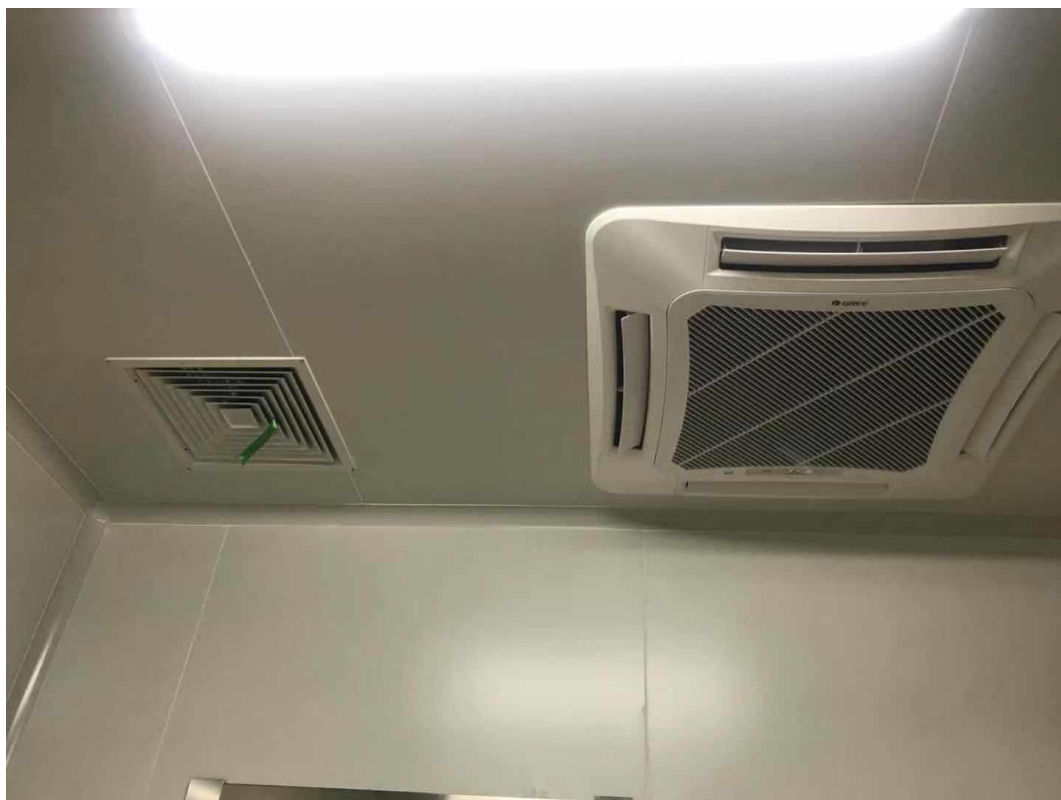
附图 12 DSA 机房通风装置
